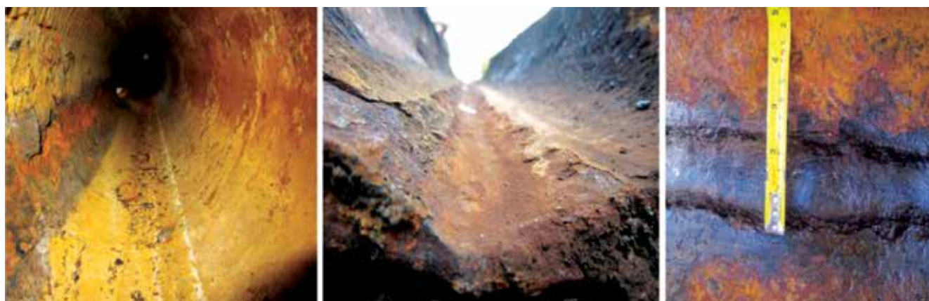
Hình 6. Ăn mòn bên trong đường ống vận chuyển nước bơm ép MSP-8 → MSP-9 tại vị trí 6 giờ.
