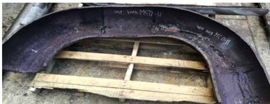
Hình 5. Bên trong đoạn nằm ngang trên MSP-11 (6 giờ) của đường ống MSP-9 → MSP-11.
